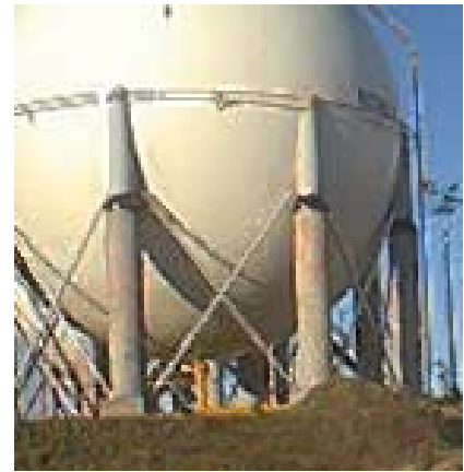
Esfera almacenamiento de GLP (posee sus "patas" ignifugadas con cemento)
