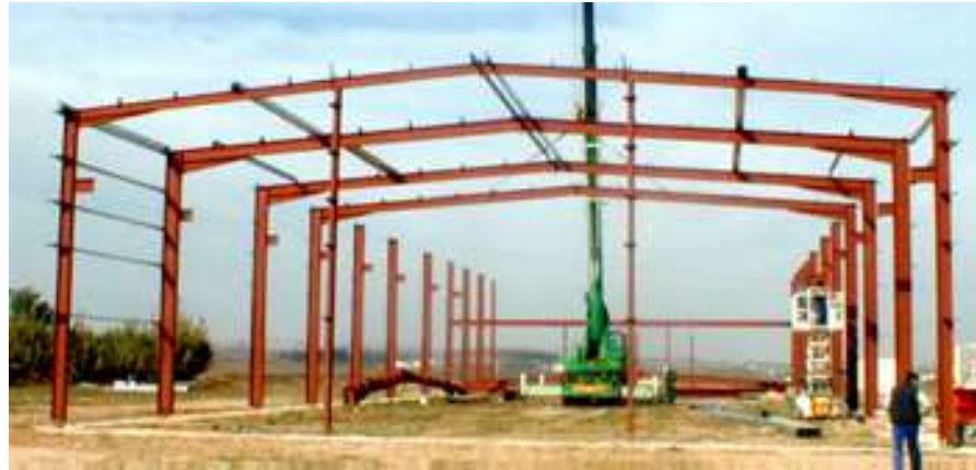
Típica estructura de acero (aquí: perfiles de alma llena), sin ignifugación
