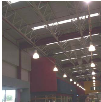
Estructuras metálicas portantes, en paredes y techos de un supermercado, carentes de igniugación
